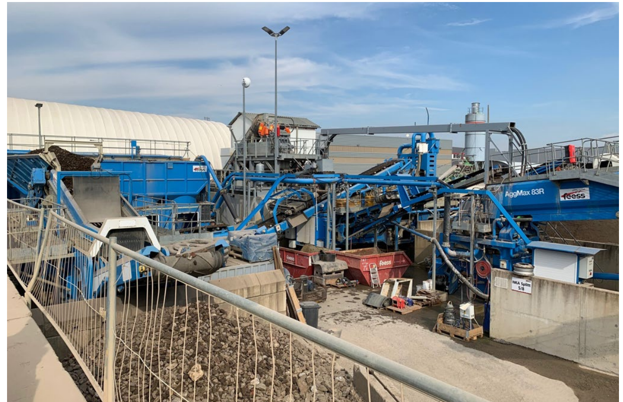
Nassklassierungsanlage der Firma Walter Feß in Kirchheim unter Teck
