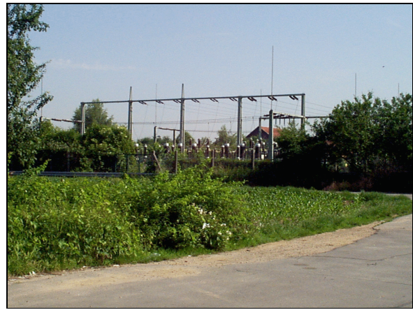
Umspannwerk „Im Hüttenbühl“
